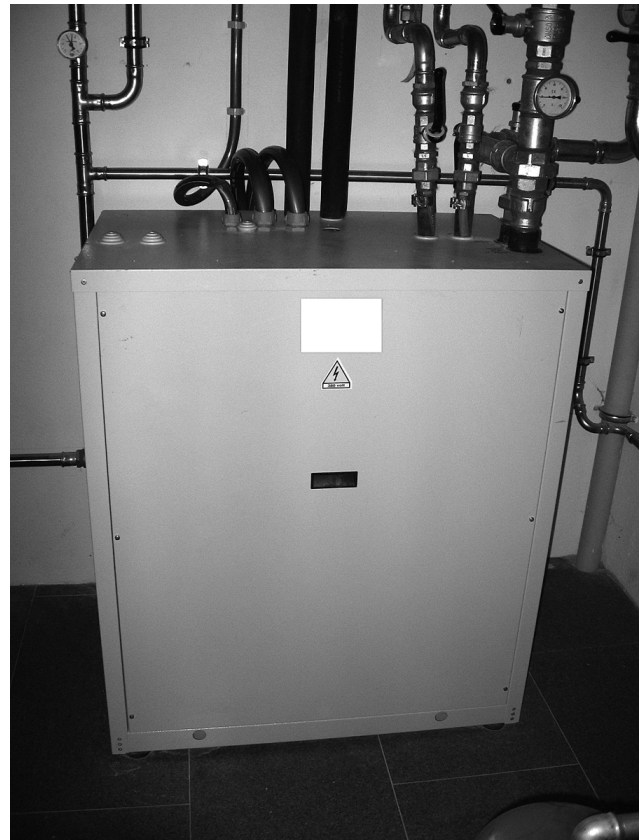
Fig. 6.10 – Pompa di calore installata su un impianto di riscaldamento di un'abitazione (foto L. Micheletti).
